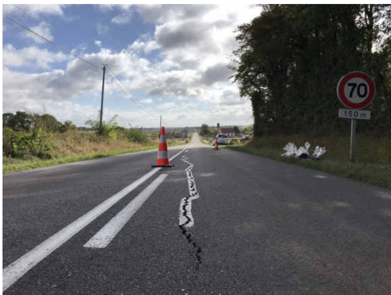
Illustration 6 : Exemple de fissures de sécheresse consécutives au phénomène de RGA
