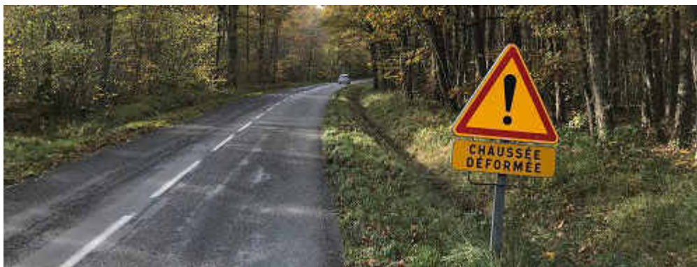
Illustration 5 : Chaussée déformée par le phénomène de retrait-gonflement
